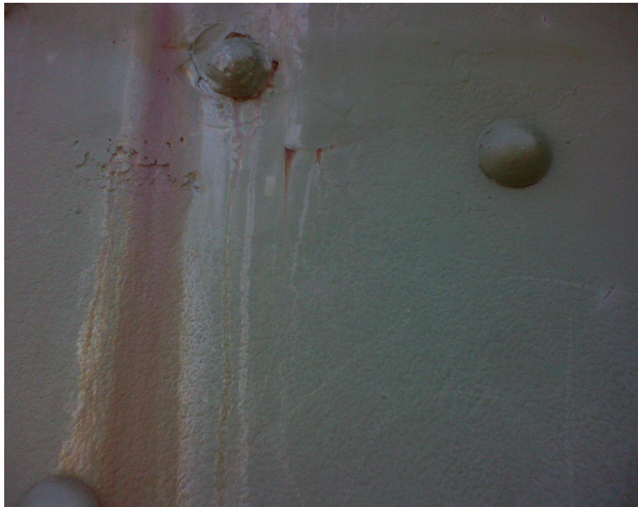
Фото 67. Следы коррозии стали проступать через краску
