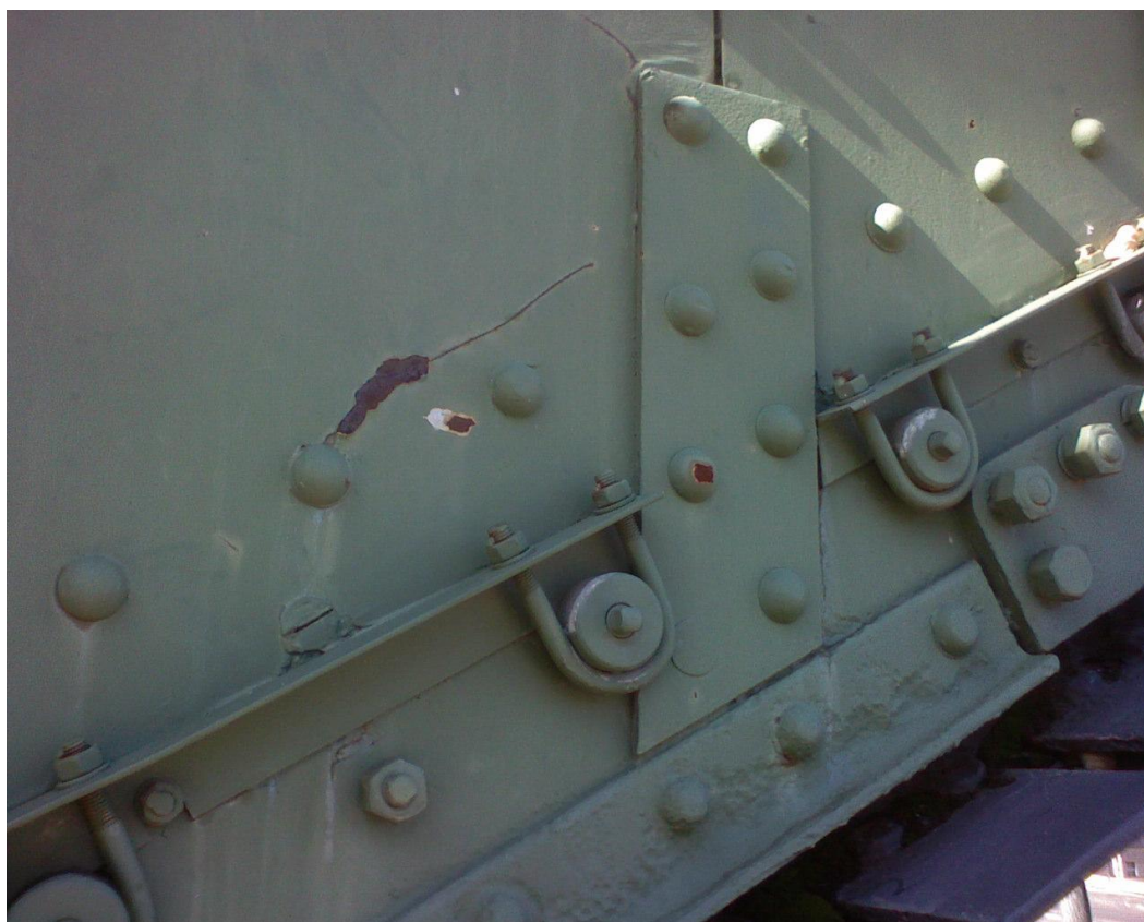
Фото 69. Трещина стала проступать через краску
