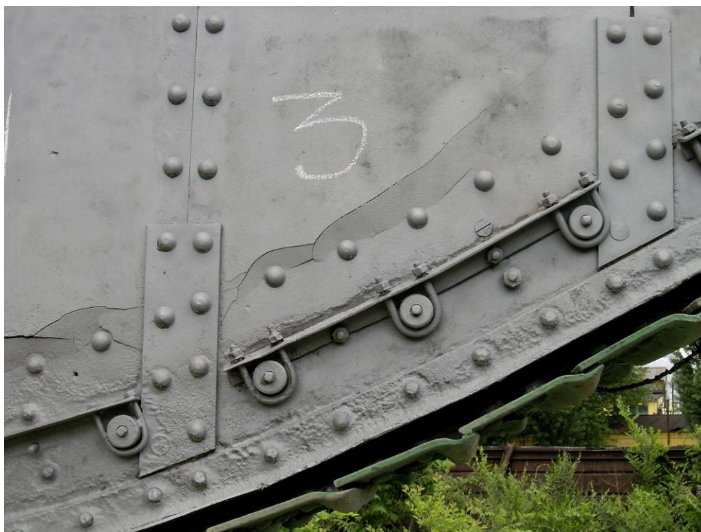
Фото 30. Трещины в нижней части
