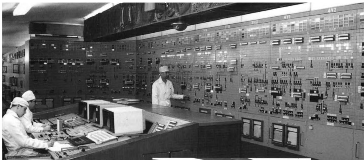
Щит управления радиохимическим производством
