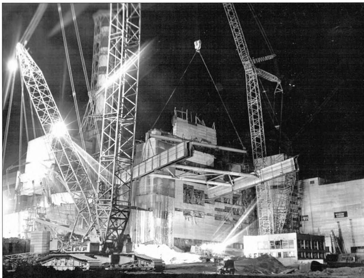
Балка «Самолет» над разрушенным блоком ночью перед установкой в проектное положение. 22 сентября 1986 г.
