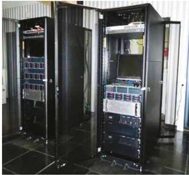
Серверное оборудование, используемое в ГУК МО РФ с 2016 г.
