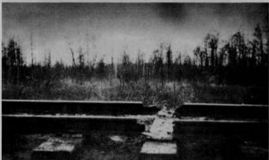
Взорванное бойцами 5-й Ленинградской партизанской бригады железнодорожное полотно у станции УТОРГОШ. Декабрь 1943 г.
